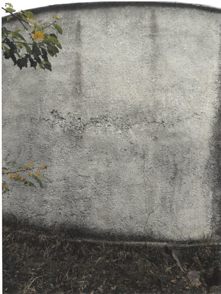
Foto 4 Segregări vizibile la nivelul rostului de turnare
