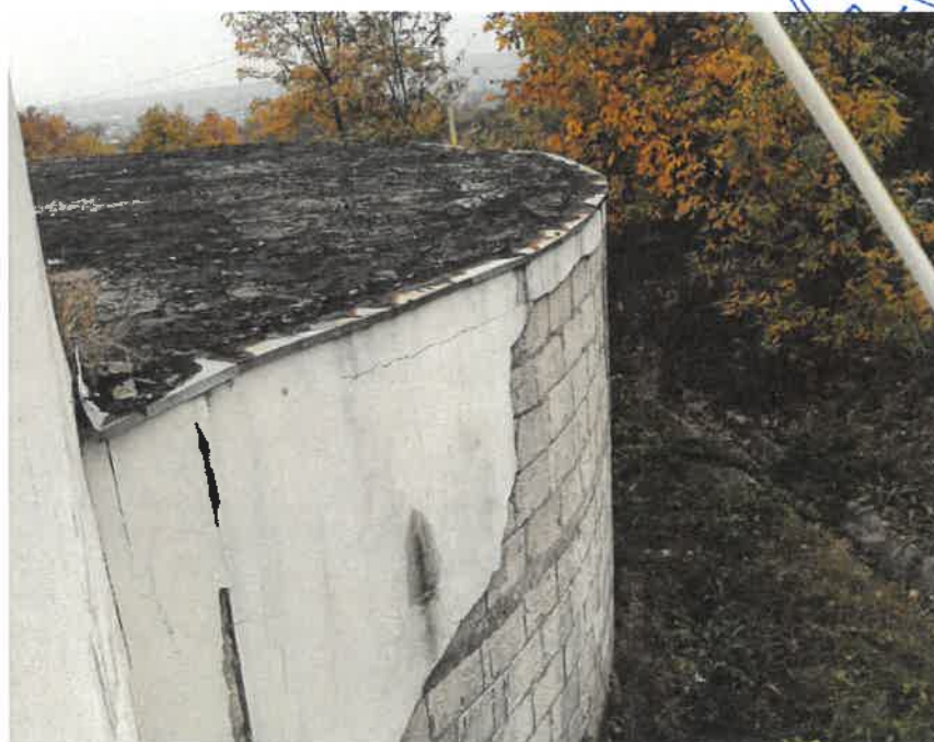
Foto 17 Hidroizolație bituminoasă degradat, lipsă jgheaburi pentru preluare apă
