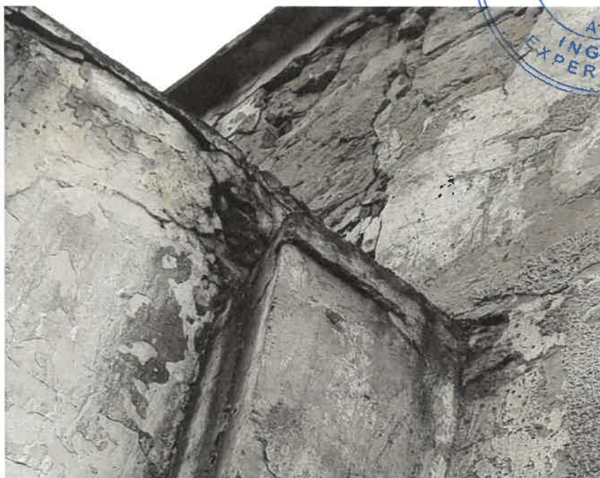
Foto 15 Clădire auxiliară cu fisuri, segregări ale betonului, lipsă termosistem, lipsă jgheaburi, hidroizolație deterioară
