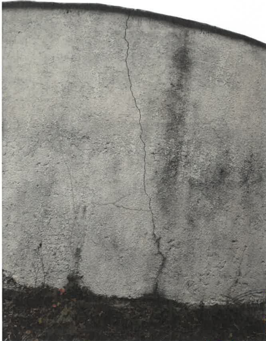
Foto 3 Fisuri verticale pe toată înălțimea rezervorului
