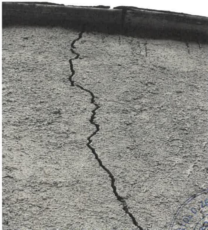
Foto 9 Fractură verticală pe toată înălțimea rezervorului
