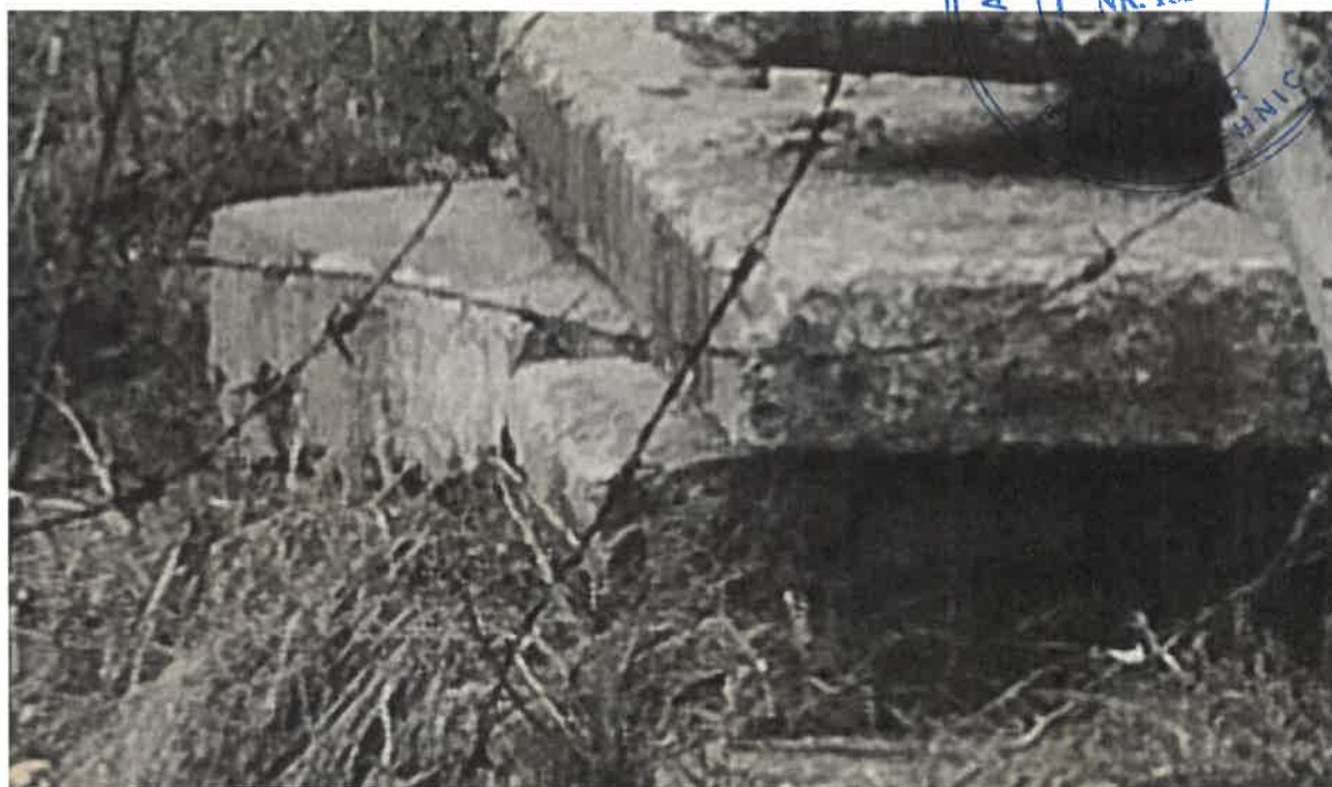
Foto 17 Placa de sus camera put, cu structura degradat
