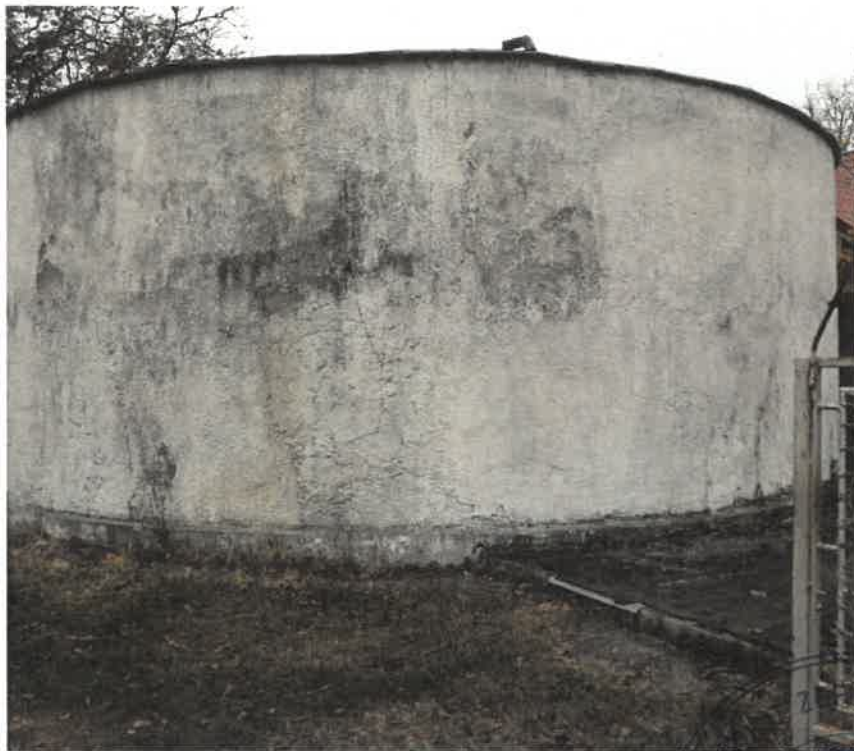
Foto 1 Vedere fațadă principală, fisuri, exfoliere tencuială exterioară
