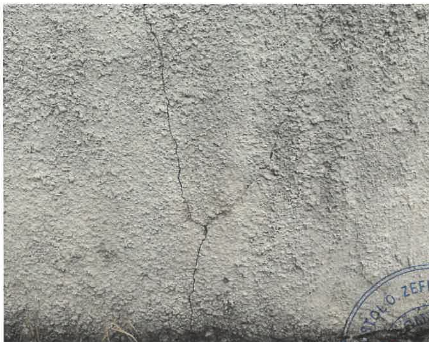
Foto 2 Fisuri înclinate, vizibile la exterior
