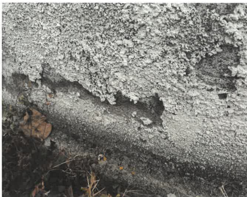
Foto 5 Exfolieri tencuieli exterioare
