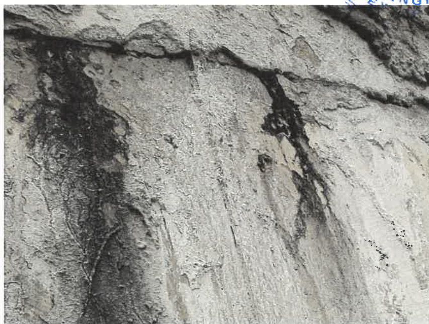
Foto 13 Rosturi de turanre cu exfiltrații și segregări
