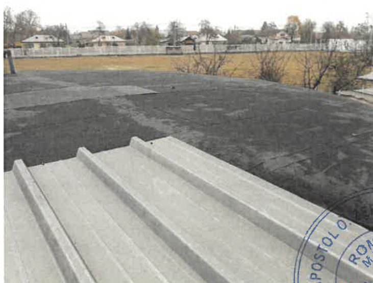
Foto 8 Montaj hidroizolație pe alocuri neconforma
