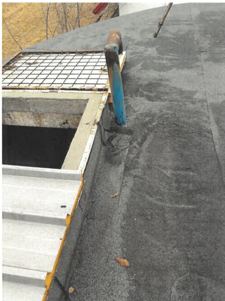
Foto 7 Lipsă jgheaburi de preluare a apelor la nivelul acoperișului
