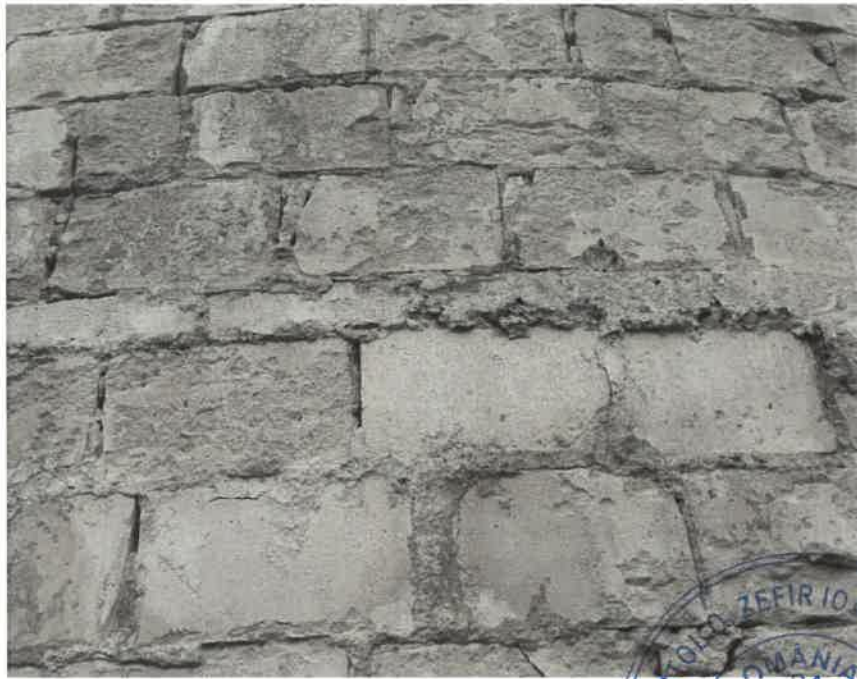
Foto 18 Termoizolație din B.C.A. degradată
