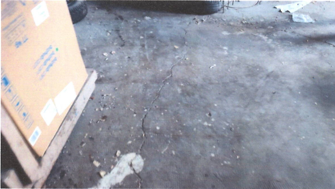
Corp C6: Pardoseală crăpată
