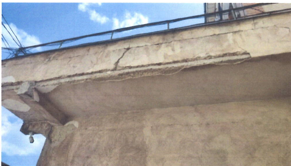
Corp C6: tencuială expulzată la intradosul plăcii peste parter; tencuială degradată la atic (tencuială exfoliată ;crăpătură orizontală la zona de contact dintre centura din beton armat de la partea superioară a aticului și parapetul din zidărie); parapet metalic și glafuri de tablă afectate de coroziune
