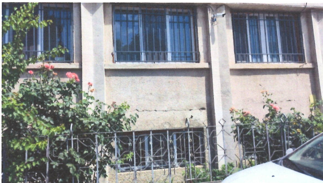
Fațada principală Corp C7: tencuială degradată (crăpătură orizontală la zona de contact dintre grinda peste demisol și parapetul din zidărie)
