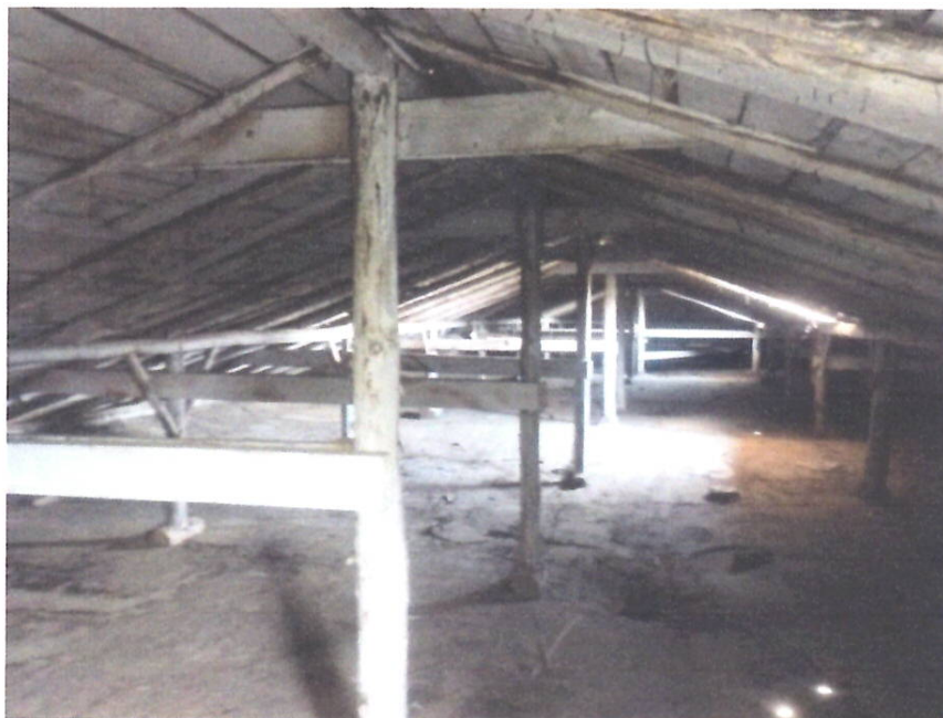
Șarpantă Corp C7: planșul în pod nu este igienizat
