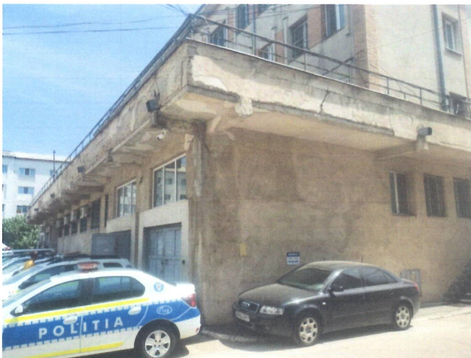
Fațadă posterioară și fațadă laterală Corp C6 - tencuială degradată la atic și la intrados planșeu peste parter
