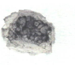
Foto 2 – Beton segregat la intradosul rampei scării
