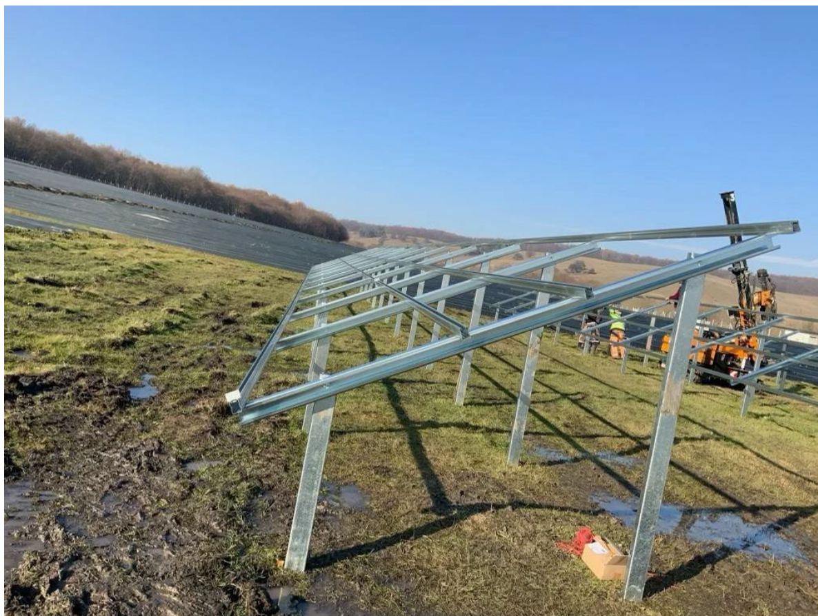
Exemplu de structura metalica pe sol
