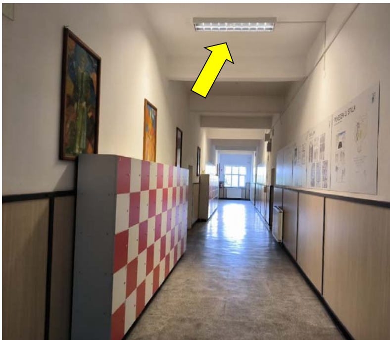
Figura 12 Poza corpurilor de iluminat din interiorul clădirii
