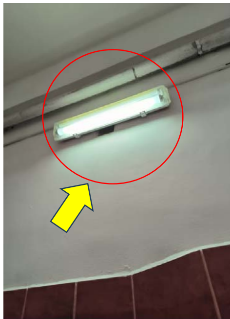
Figura 7 Uzura și insuficiența luminoasă a corpurilor de iluminat
