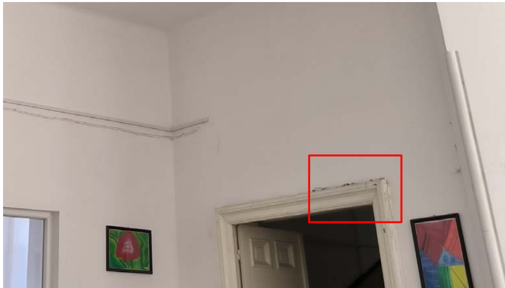
Figura 6 Degradarea spațiilor interioare și decolorarea peretilor
