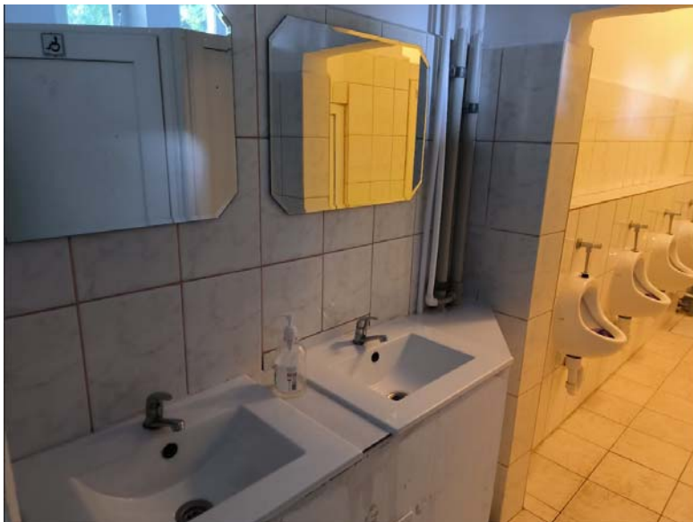
Figura 8 Uzura morală și funcțională a grupurilor și obiectelor sanitare
