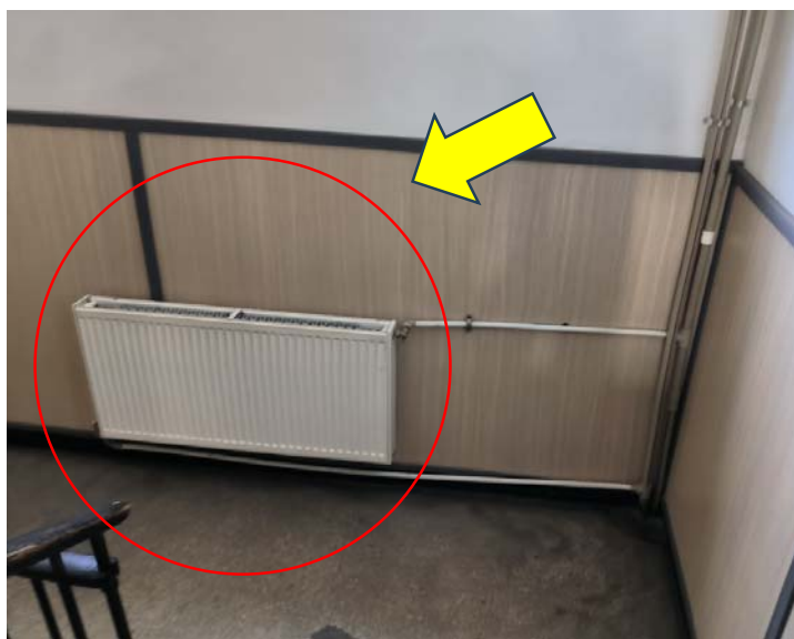
Figura 11 Poza corpuri de încălzire – instalație de încălzire
