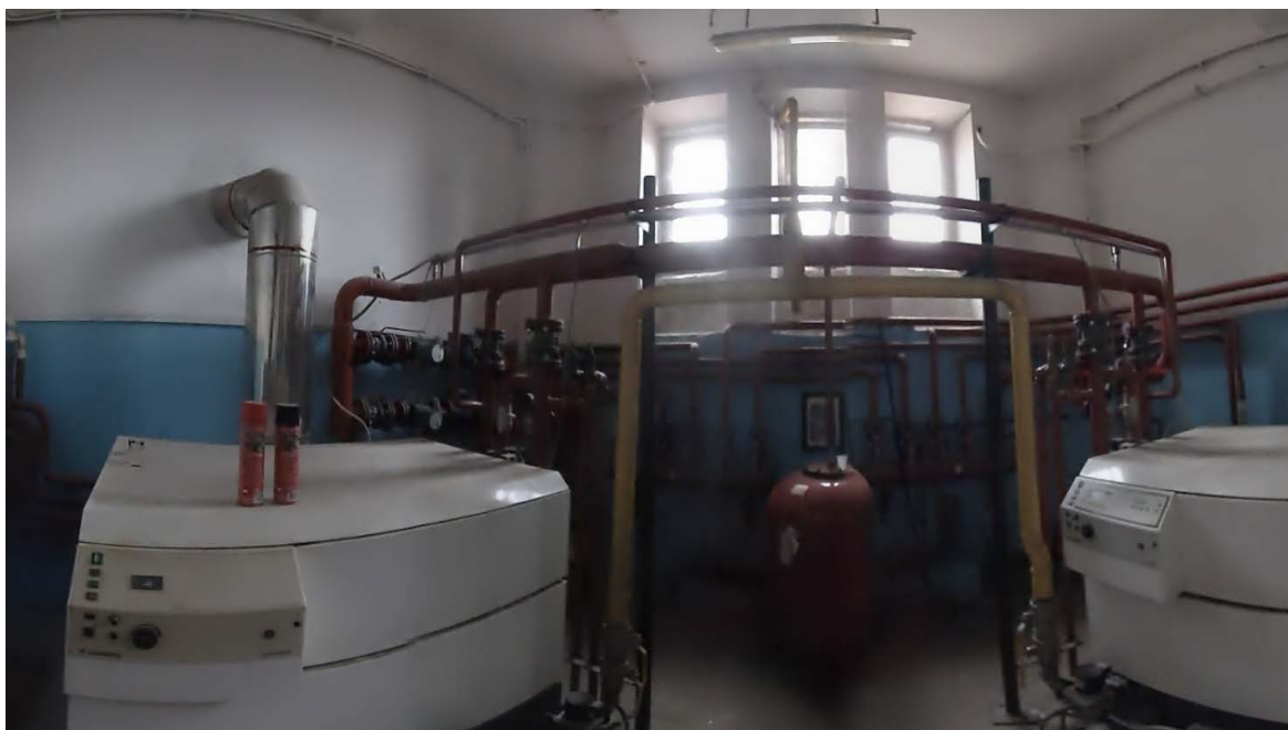
Figura 9 Instalația de încălzire a clădirii
