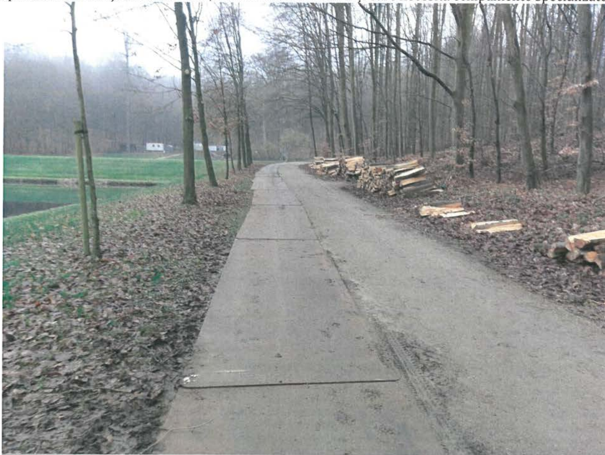
Fig. 5 - Exemplificare a modului în care poate fi protejat solul pe parcursul realizării intervențiilor în zonele pe care se deplasează echipamentele grele: soluție tehnică în care sunt utilizate foi groase de tablă
