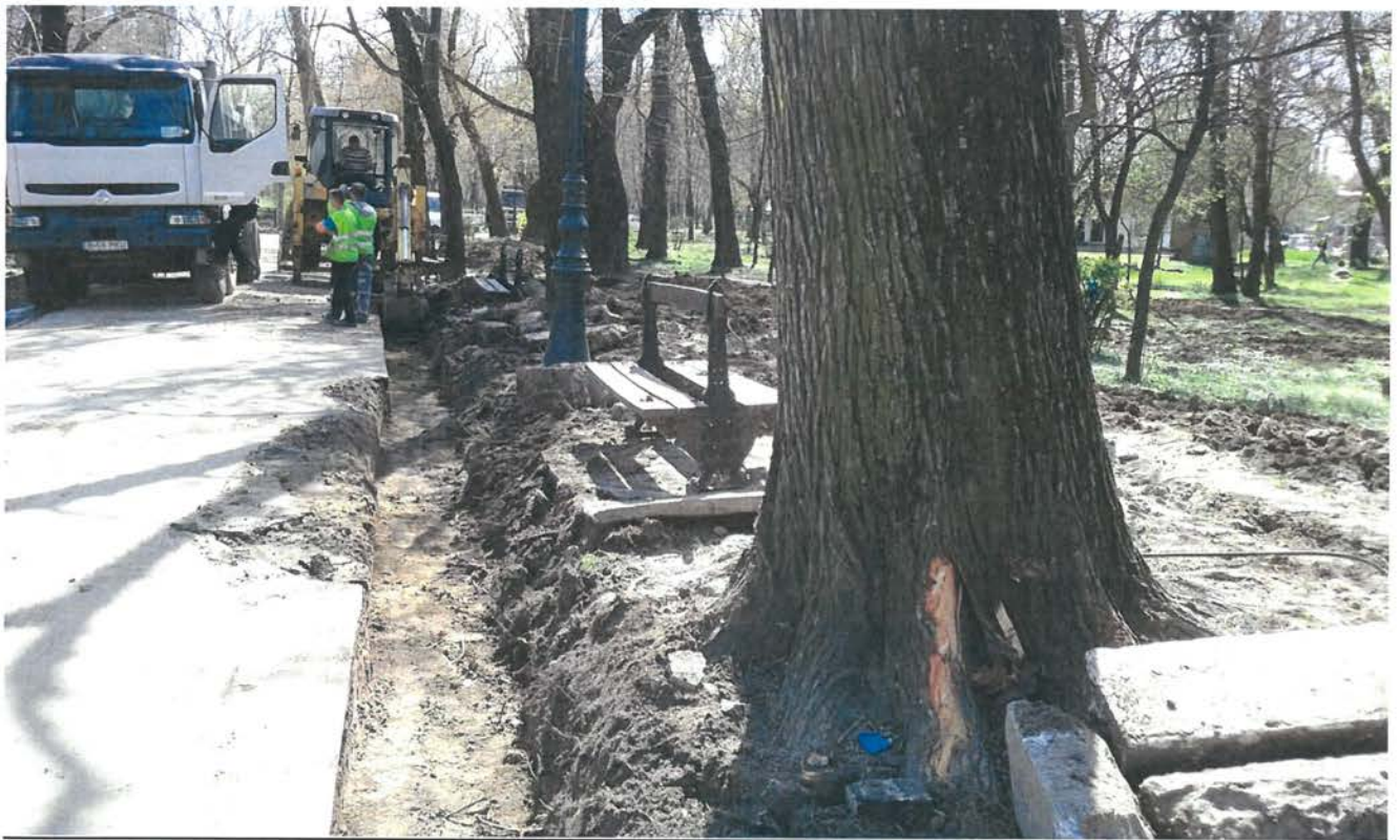
Fig. 1 - Exemplu referitor la rănirea trunchiurilor arborilor existenți pe parcursul realizării unor intervenții de amenajare în lipsa instalării unor sisteme de protecție
