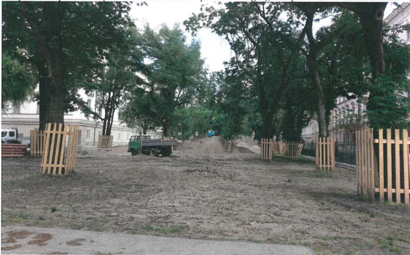
Fig. 6 - Exemplificare referitoare la protejarea Zonei radiculară Critice (ZRC) pe parcursul lucrărilor de amenajare: soluție cu împrejmuire realizată din lemn
