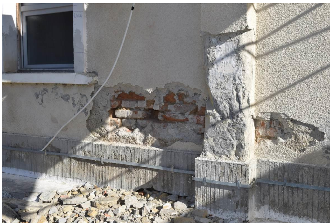
Stâlpi fatada posteriora care necesită întărire cu lamele din beton armat adiacente
