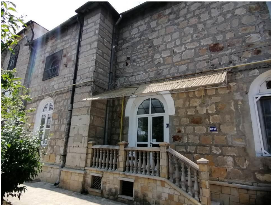
Fatada principala (fisuri)
