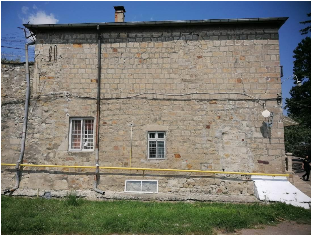
Fatada laterala stanga (fisuri)
