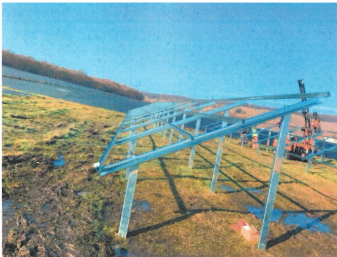
Exemplu de structura metalica pe sol
