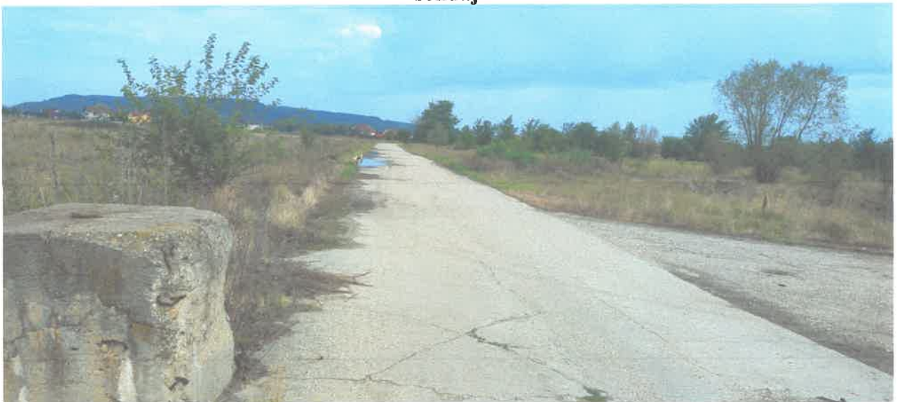
Str. 13 Septembrie – beton degradat
