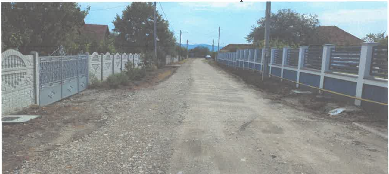
Str. Teiului – ramură stg.= asfalt degradat de “Canalizatori”
