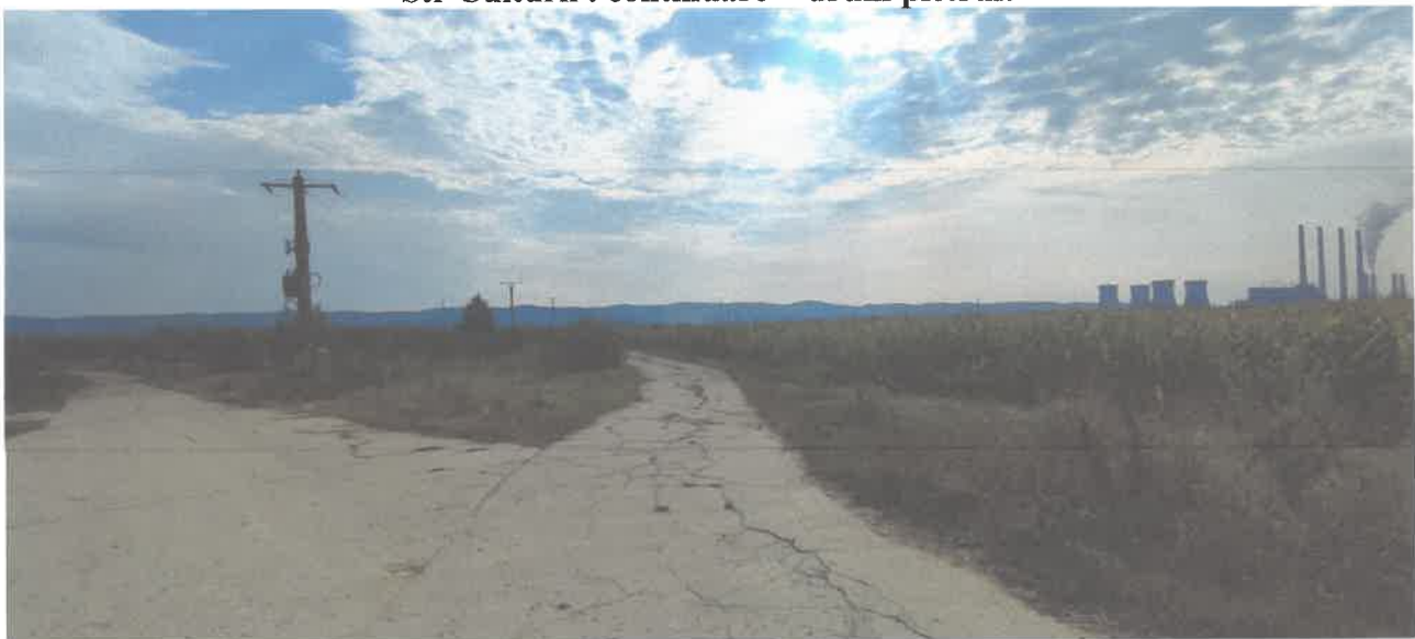
Str Culturii: ramură dreapta: beton degradat
