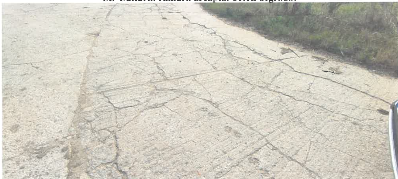
Str Culturii: ramură dreapta (spre cimitir): beton degradat
