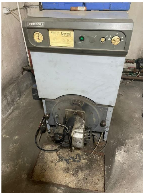
Figura 8 Instalatia de incalzire a cladirii
