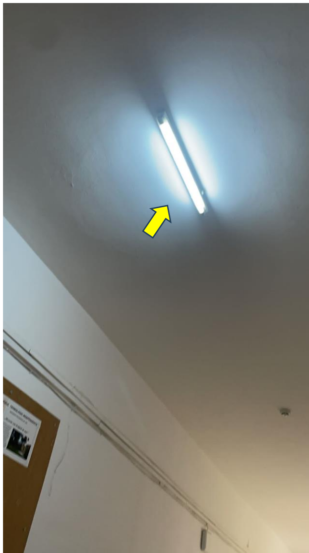
Figura 6 Uzura si insuficienta luminoasa a corpurilor de iluminat
