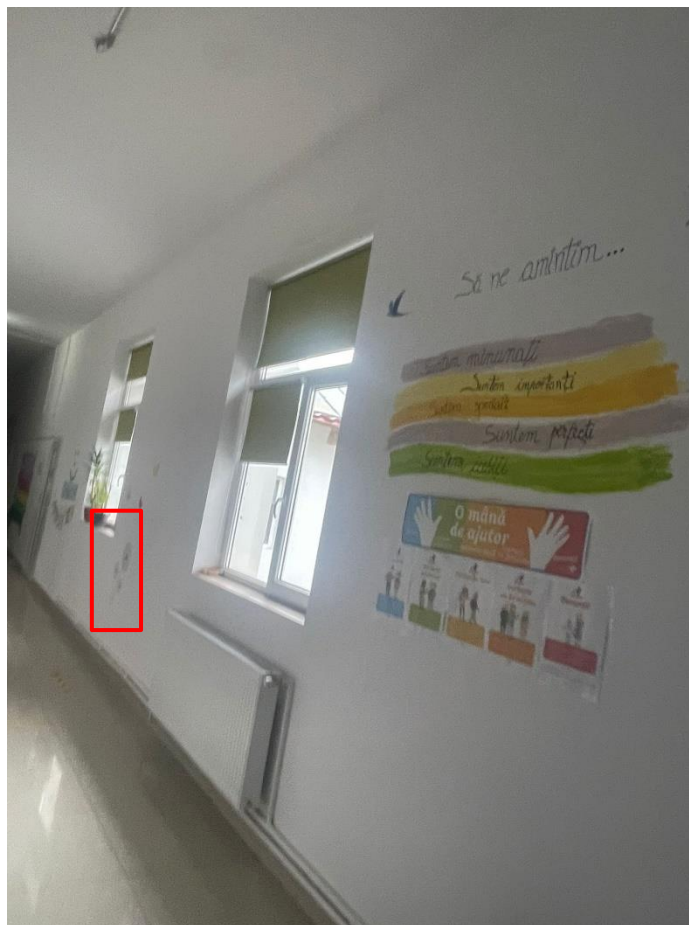
Figura 5 Degradarea spațiilor interioare și decolorarea peretilor
