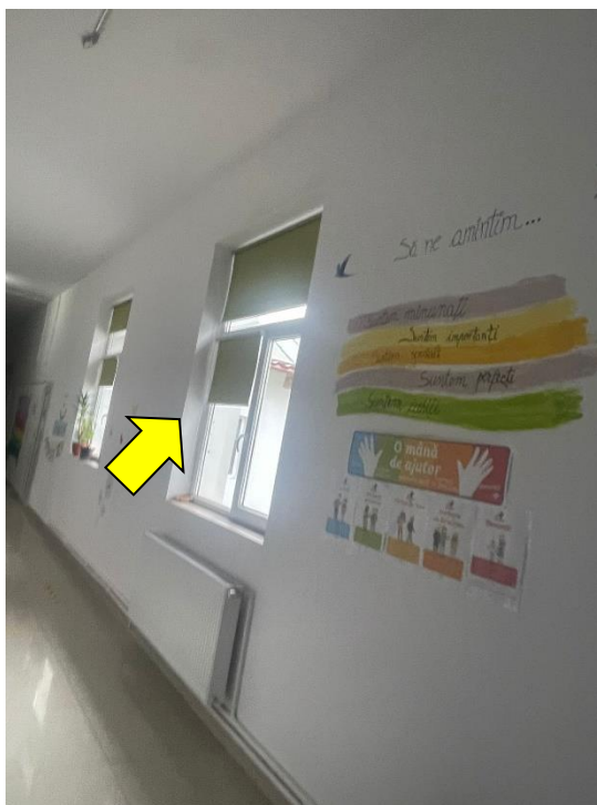
Figura 12 Protecții solare improvizate la nivelul sticlei interioare
