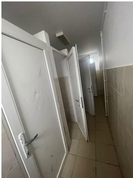
Figura 7 Uzura morala si functionala a grupurilor si obiectelor sanitare
