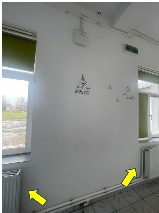
Figura 10 Poza corpuri de incalzire – instalatie de incalzire
