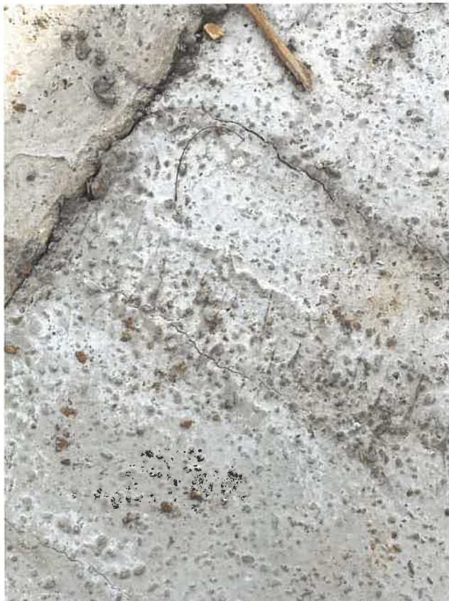
Fisuri in pardoseala nou turnata si tasari diferite intre pardoseala si grinda de fundare. Rost de turnare impropriu! Vor aparea fisuri in gresie!
