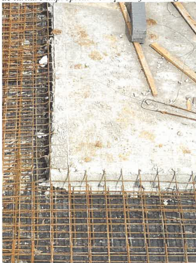
Plase de armatura expuse la suprafata betonului fara capre ( 3 buc/mp conform proiect) si indoite in zona rostului de turnare cu beton expulzat.
