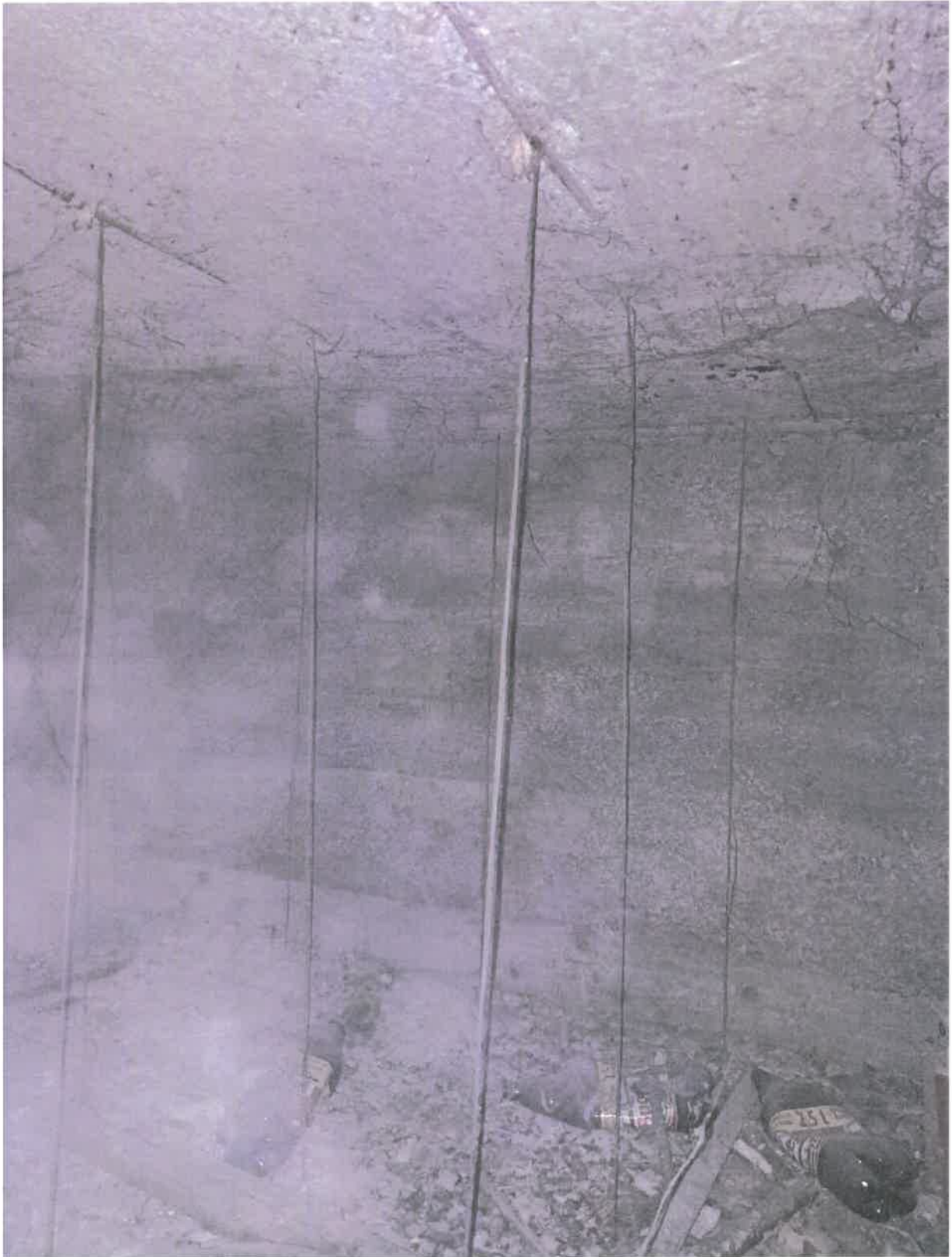
Figura 5. Vedere din tavanul fals – se observa ca ancorele au fost sudate de armatura din placa existenta
